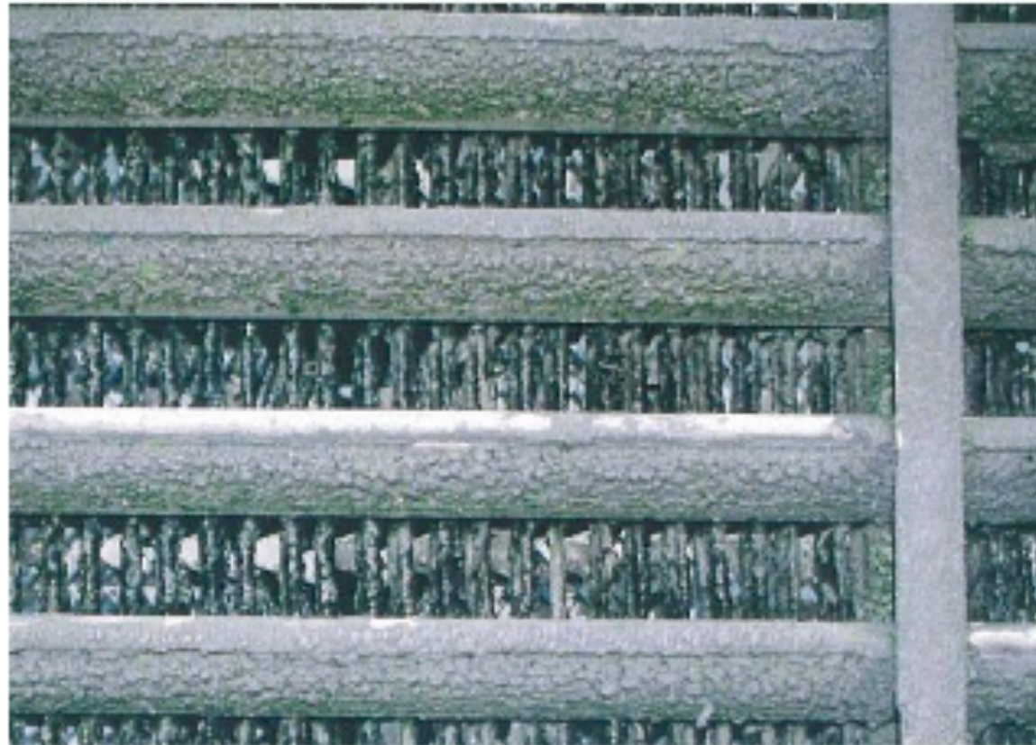
スケール・シリカ剥離前の状態(設置時)
